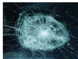
État de brisure du verre feuilleté
